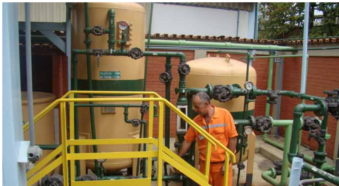
Estação de tratamento tem capacidade para processar 120 mil litros de água por dia, o equivalente ao consumo de uma população de 1.700 habitantes
