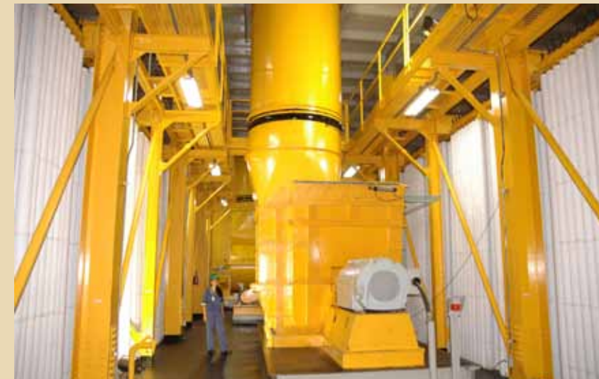
Equipamento de ponta, filtro de ar, tipo mangas, empregado nas operações da Sama assegura a qualidade do ar além dos limites legais
